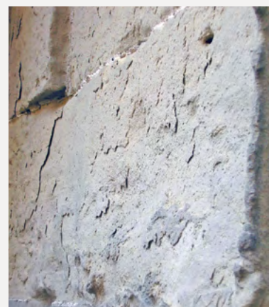
Alcuni esempi di degrado di murature a faccia vista.
